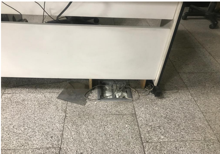
عدم ساماندهی سیم‌های برق و جانمایی نامناسب
